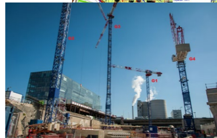
4 grues, dont 2 ont été ancrées aux ouvrages, auront été nécessaires à la construction des tours Duo
