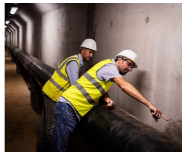
Galerie technique avec équipements hydraulique, sous les remblais du barrage Moreau
